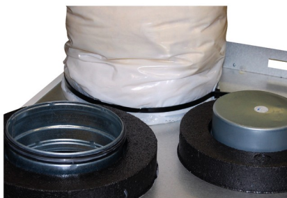
Färdigmonterade kanaler vid aggregatet.
